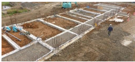
文責： あっという間に基礎も完成。寒い雨降りの中、工事を進めて下さる方にただただ感謝の卒田
